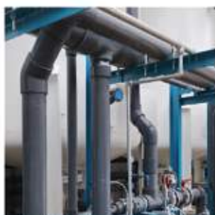
Maquinaria de la Planta de tratamiento
